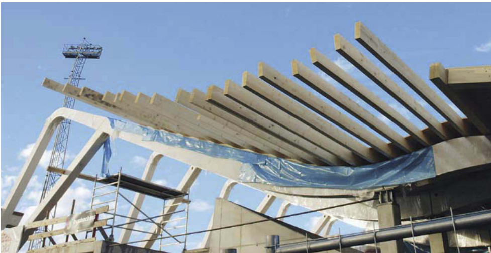
▲ Quer zum Haupttragwerk verlegte Brettlamellen wurden später oberseitig beplankt. Gemeinsam bilden sie aussteifende Scheiben
