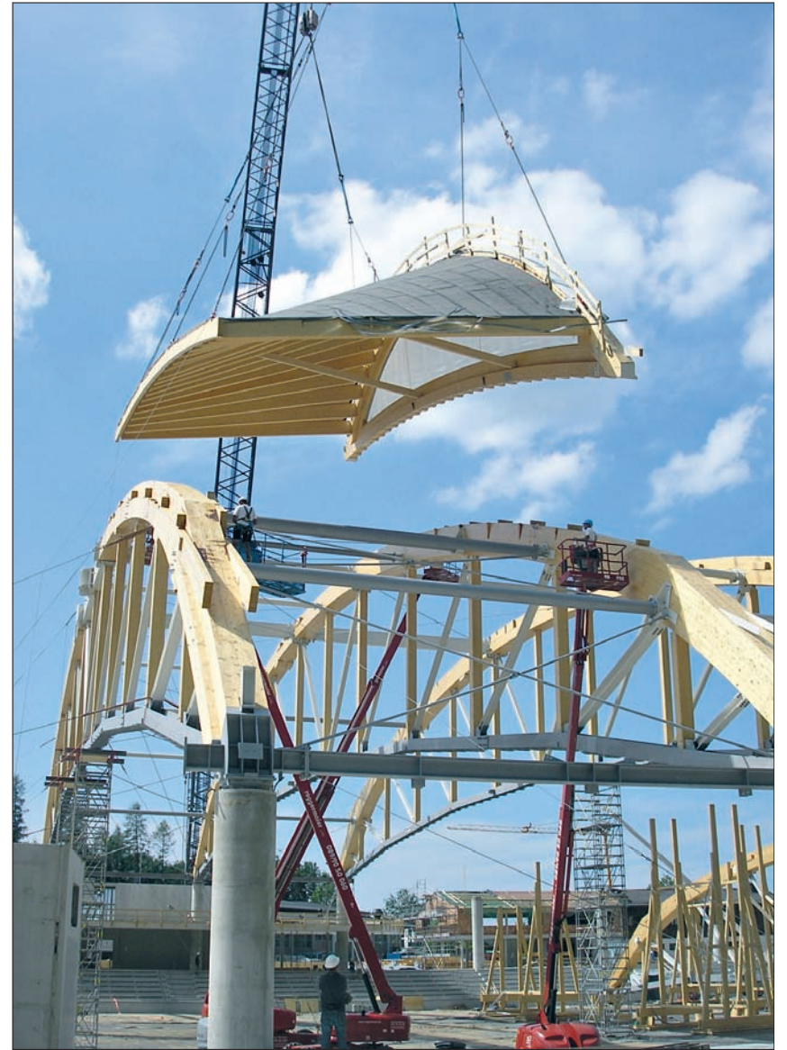
Über den montierten Fachwerkträgern schwebt ein halbmondförmiges Shed ein. Foto: Grossmann Bau GmbH & Co. KG
