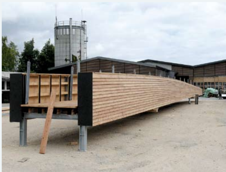
Das 35 m lange, vorgefertigte Brückenteil mit Schalung, Belag und Geländerpfosten, das vom langen Endfeld 12,5 m ins Mittelfeld hinein ragt.
