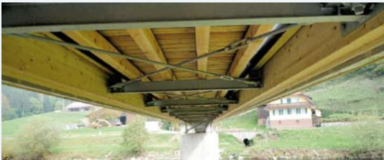
Brückenuntersicht mit liegendem Verband aus Stahlauskreuzungen zur Stabilisierung und Aussteifung der Brücke.
